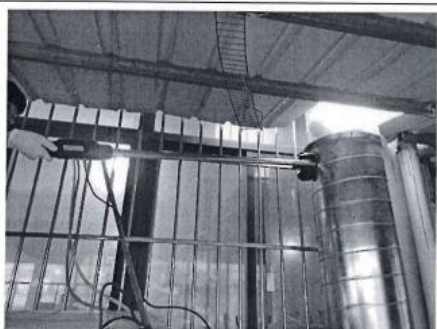
塑封废气处理设施进口
