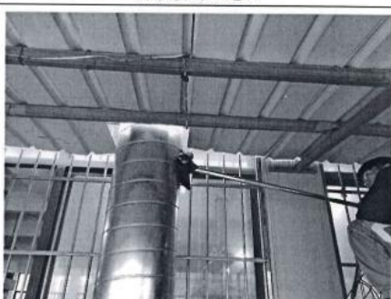
塑封废气处理设施出口
